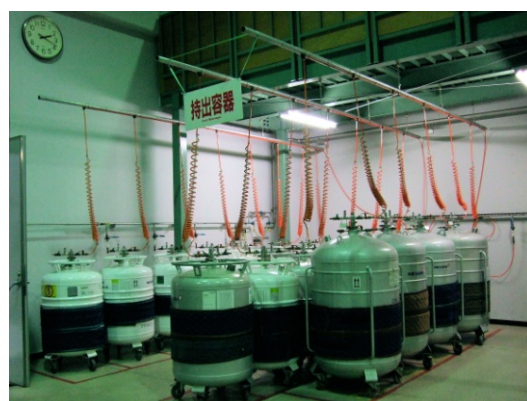
図 7. 液化室内の He 容器回収配管接続状況
