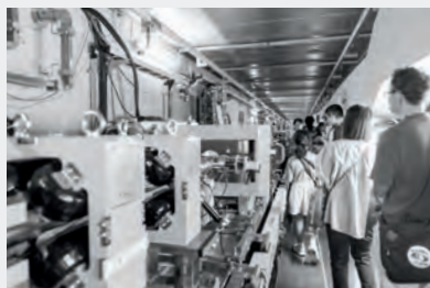
▲ 先端加速器試験施設 ATF
