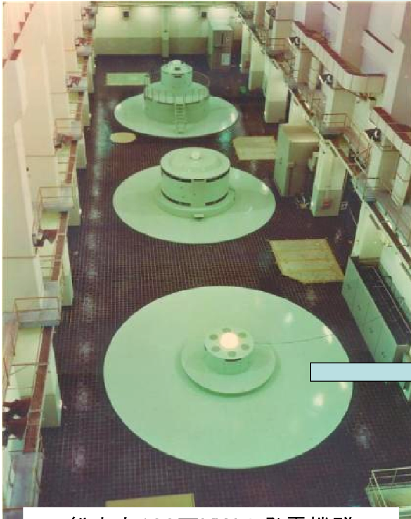
総出力100万KWの発電機群
