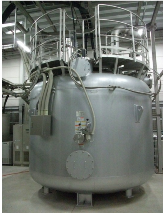
図 4.3.3 10 MVA-SMES 商用機のエネルギー貯蔵部外観
