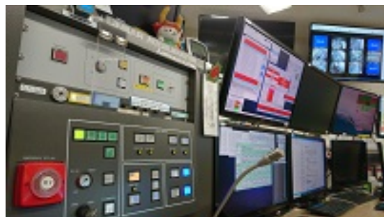
最新の制御パネルとコントロール室内
