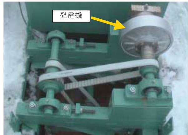
写真5 増速機及び発電機 (写真2 上部矢印視野)
