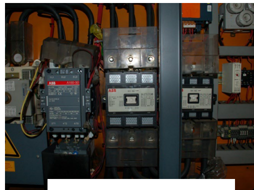
写真5：コンプレッサー電源
