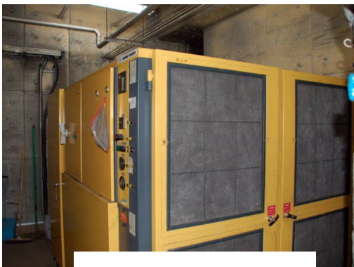
写真4：コンプレッサー
