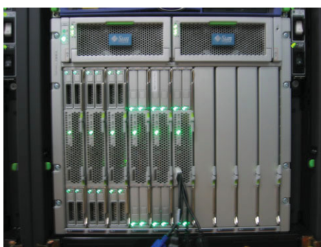
参考：稼働中の Sun Blade サーバ
