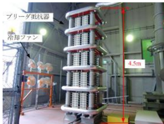
図 3. 加速電源ブリーダ抵抗器
