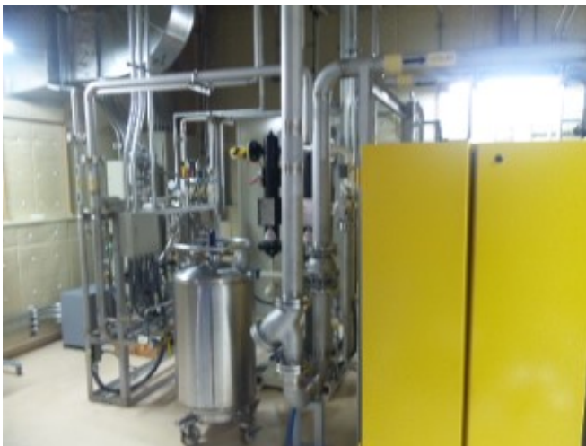
図1 3 第2ヘリウム圧縮機棟：オイルセパレーターおよびバルブステーション(左)、ヘリウム圧縮機(右、黄色)
