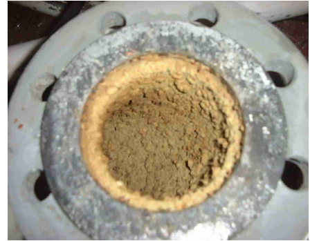
写真2 冷却水配管内部のさび
