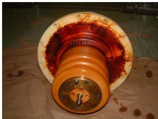
図5 放電により変色したブッシング
