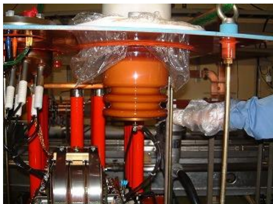
図4 高圧オイルタンク内部
