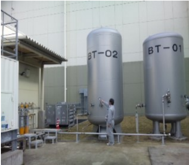
図1 2 屋外ヤード：冷却塔（左）、カードル（中央）、バッファタンク2基（右）
