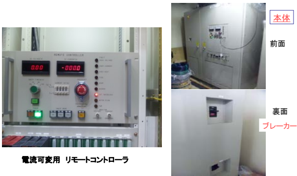
図8 電流可変用リモートコントローラ 及び超伝導ソレノイド用直流電源
