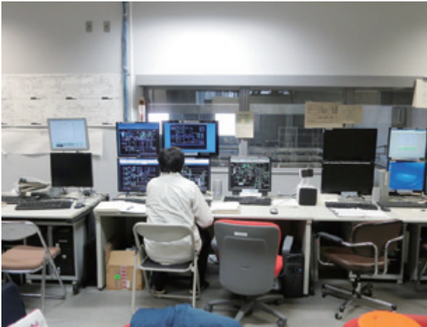
ニュートリノビームライン冷凍機制御画面
