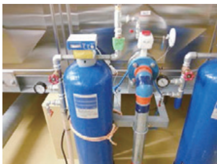
図 5.1.5 貯留槽に設置されたイオン交換樹脂
