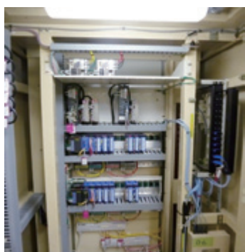
ラック内装置（光多重、PLC、電源など）
