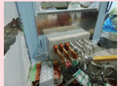
【ケーブル貫通部】
