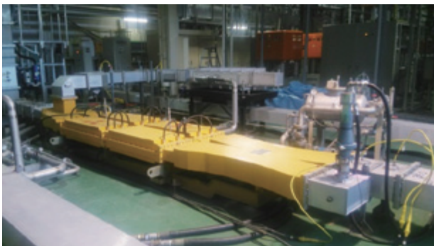
508.9 MHz, 1 MW 4-port サークュレーター
