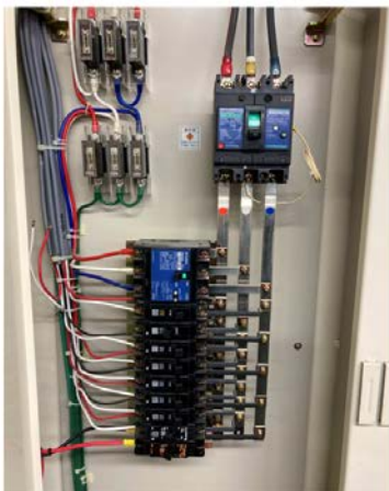
図1. #3111 分電盤 改造前
