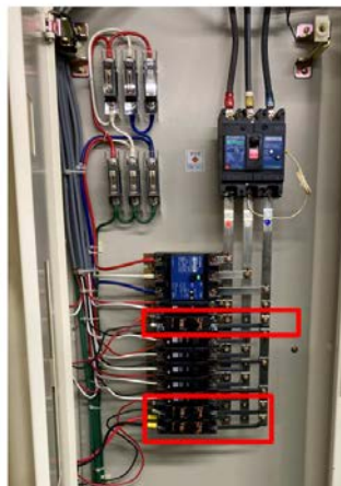
図2. #3111 分電盤 改造後
