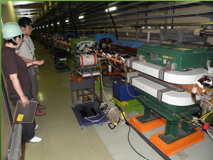
KEKB解体前の放射化マグネットの 放射能測定
