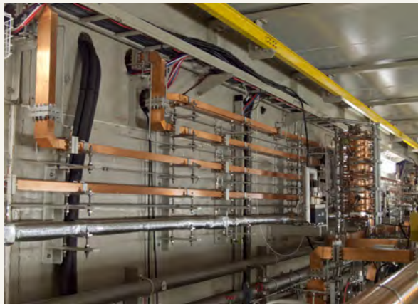
KEK の ATF (先端加速器試験施設) の線形加速器に使われている導波管。左の壁面に走っている銅の四角い管が導波管である。
