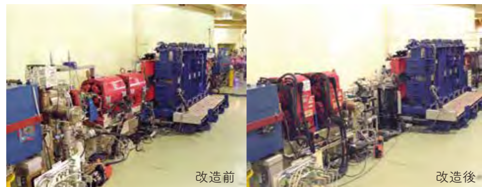
2005年 直線部増強改造により、既存の直線部は延伸され、新たな直線部が6箇所誕生した。写真はBL-2のアンジュレーター（右側の青い装置）。赤色の4極電磁石を更新して短くすることにより、アンジュレーターの上下と下流にそれぞれ2mの空間が新たに作り出された。
