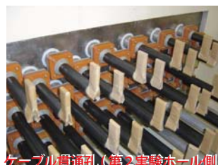
ケーブル貫通孔(第2実験ホール側)
