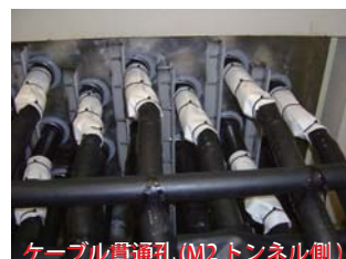
ケーブル貫通孔(M2トンネル側)
