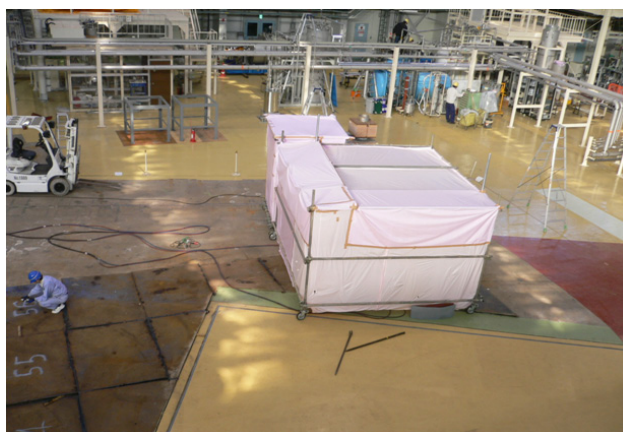
図5 旧ビームラインの上流部に敷かれていた、放射化した鉄板およびモルタルの除去作業の様子。
