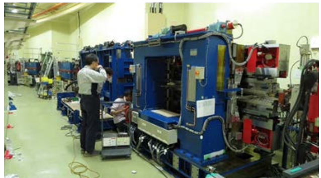
図2 PFリング北直線部に設置された可変偏光アンジュレータU#02-2(右)。下流に設置されているのが、既設アンジュレータU#02(左)。
