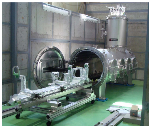
図1 9月下旬に AR 東第2実験棟のコンクリートシールド内に据え付けが完了した横型クライオスタット。
