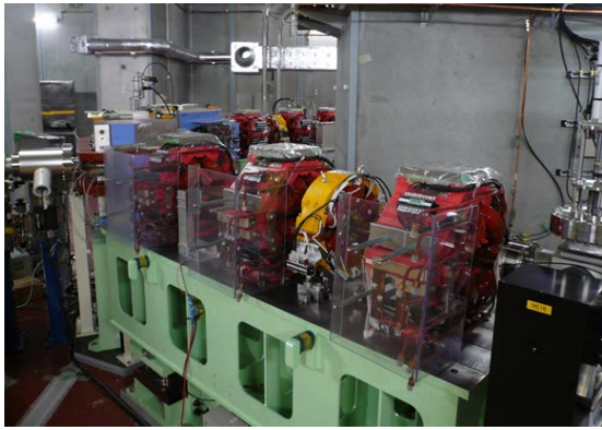
図2 共通架台の上に設置されたバンチ圧縮用の6極電磁石（黄色の電磁石）です
