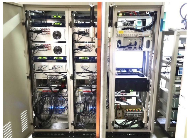
図1 パルス電磁石電源が設置された筐体
