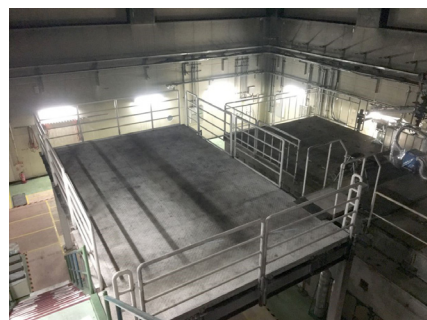
図2 火災直後の加速管組立室、焼損した電源は奥で見えていない（上）。被災機器を撤去・廃棄し高所回復作業の準備が進んだ最近の状況（下）。
