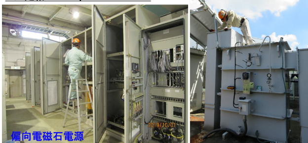
2006年TEMIC社製 5盤面の大型電源 フル定格 1500A/1200V : 1.8MW
