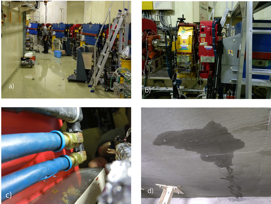
図 1 PF リング内での漏水状況。a) 床面に水が広がっていることがわかる。b) 右側の青色の磁石が偏向電磁石 B19、中央の赤い電磁石が漏水した Q201 磁石であり作業スペースが非常に狭いことがわかる。c) 4 極電磁石冷却水ホース破裂部分の画像。ホース取り外し前に絶縁シール等を除去した状態。下側のホースに裂けている部分があり、バルブを閉めたあとでも水滴が出ているのが見える。d) リング床（トレンチ天井）部分からもひび割れ部分から水が落ちている。
