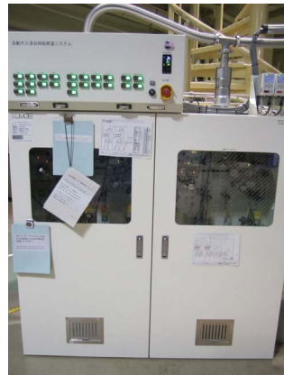
図 1 可燃性および支燃性ガスのシリンダーキャビネット
