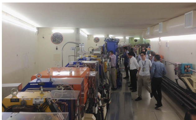
図2 TPS トンネル内見学の様子。右側の壁に沿ってブースターリングが設置されている。
