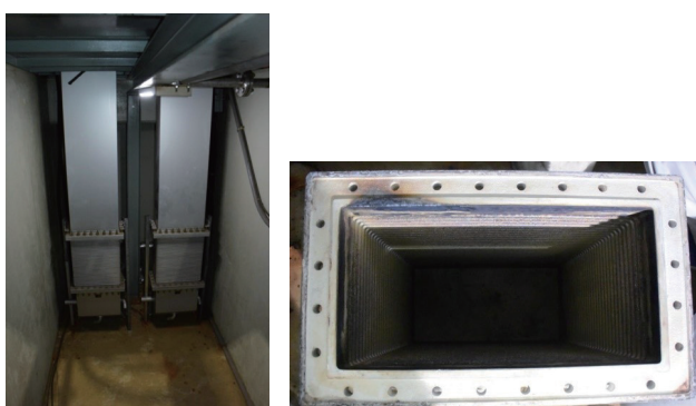
図 2-16（左）交換したピット内の古い導波管箇所。（右）交換した導波管の不具合箇所の例。放電痕のようなものが見られた。
