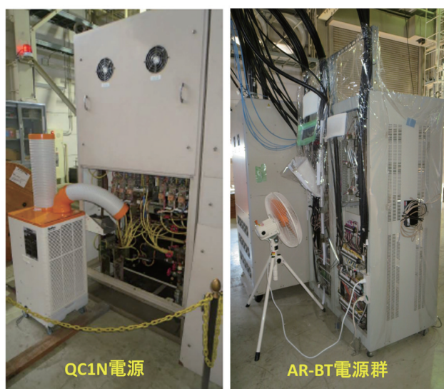
図 2-1 (左) 製作より 35 年が経過する老朽化電源の冷却応急処置。(右) AR-BT 電源群ラックの冷却応急措置。粉塵に弱い精密電源のため空冷ファン付きクリーンブース化している。冷却能力不足により応急処置を実施。
