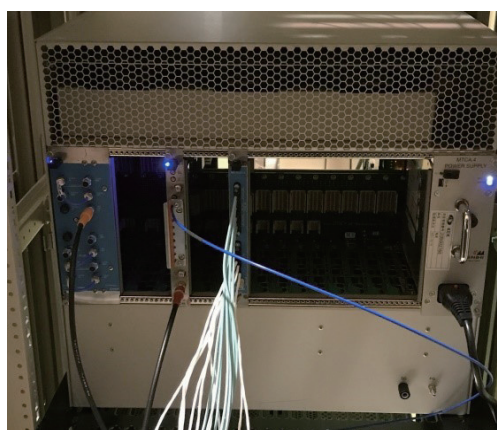
図 1-11 試験中のデジタル低電力高周波制御系の一部。
