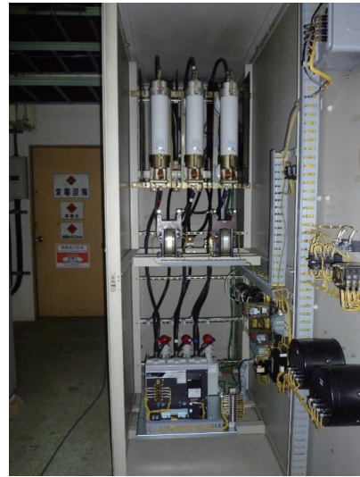
図 1-2 部品交換後の PF リング高圧受電盤(上部の白い円筒 3 本がヒューズ、下部が真空式電磁接触器及びサージアブソーバ)。
