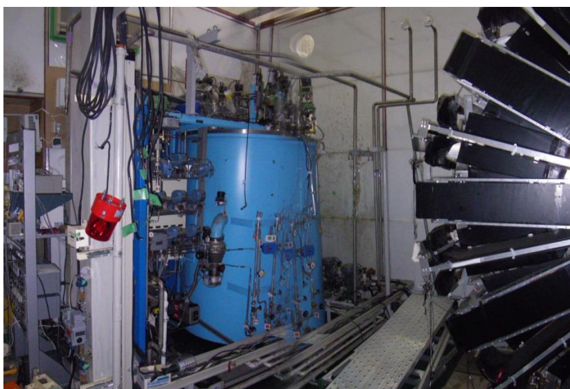
図 3 状態確認を進めている旧トロイダル磁石用冷凍機（水色の機器）
