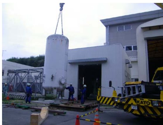
(b)圧縮機及びバッファタンク
