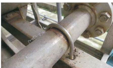
図 2 腐食個所、U ボルトで配管を固定しているが、金属どうしが接触した個所で孔食が発生していた。
