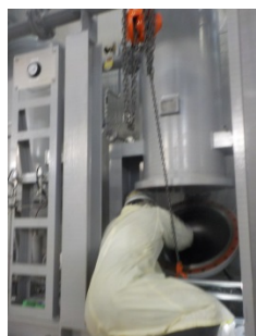
図 3 2次オイルセパレーター外観
