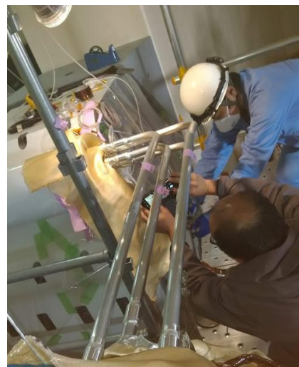
図 2 輸送ソレノイド湾曲部の冷却配管つなぎ込みが完了した。
