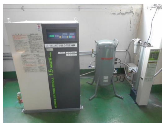
(b) 計装用圧縮空気供給装置
