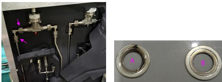
図 3 リークの状況：(左) 漏えい個所のジャンクションボックス内部の継手。(右) 交換したメタルパッキン。汚れたものが使用されていた。
