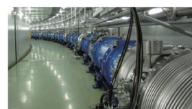
ニュートリノ実験施設超伝導マグネットシステム
